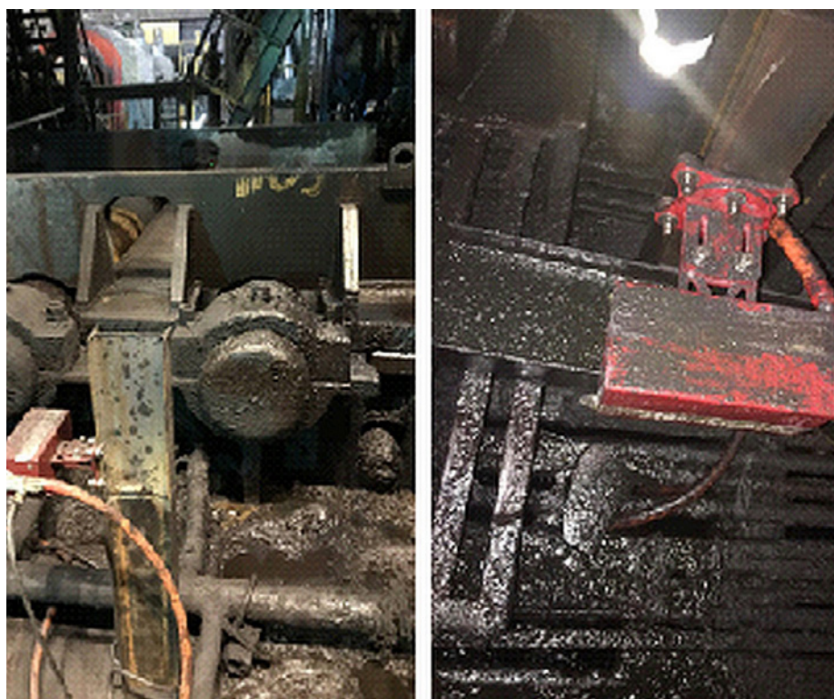
Bild 7. Installierte Radar-Breitenmessung vor dem Staucher im Warmwalzwerk (Fotos: ASINCO)
